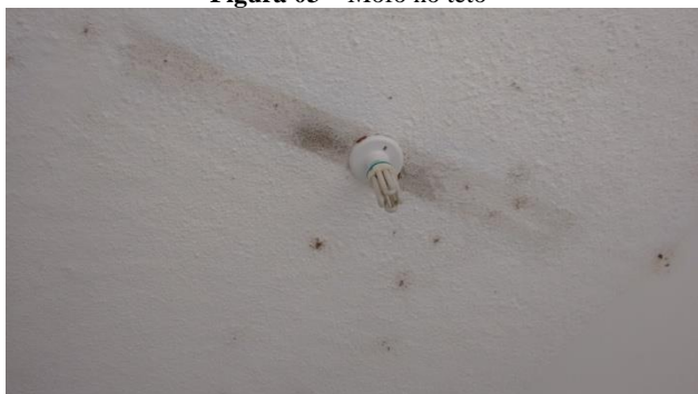
Figura 03 – Mofo no teto
