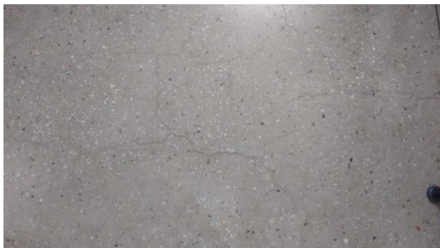
Figura 01 – Fissuras no Piso da Sala de Aula no Prédio 3
