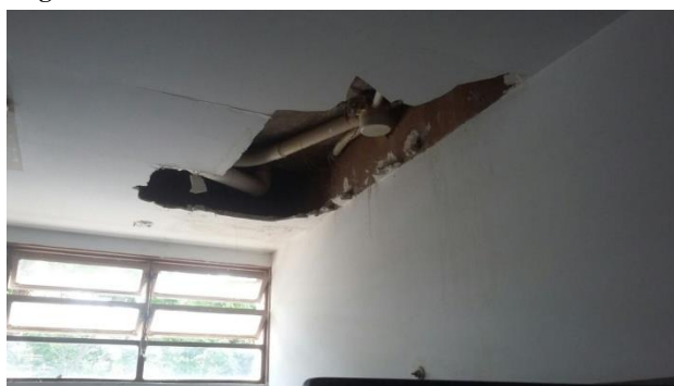
Figura 06 – Problemas com Gesso na cobertura de banheiros
