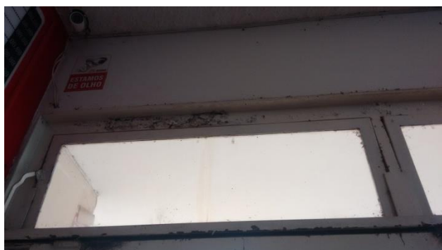
Figura 05 – Corrosão em Janelas
