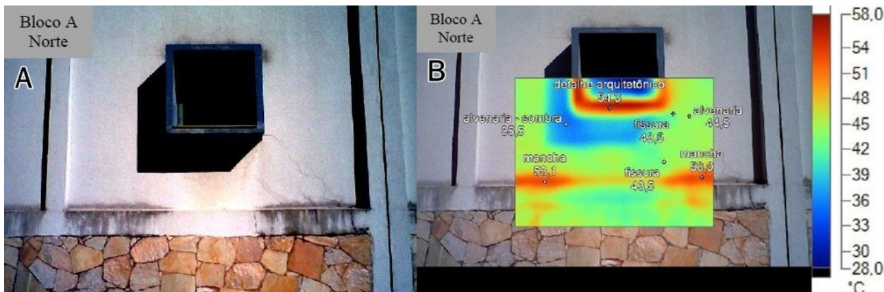
Figura 1. Fig. 1A: Fotografia de uma região da fachada norte do Bloco A da Universidade Federal de Goiás (UFG); Fig. 1B: Fotografia Termográfica da região da fachada norte do Bloco A da Universidade Federal de Goiás (UFG), sobreposta à Fig. 1A. Fonte: FREITAS; CARASEK; CASCUDO, 2014.
